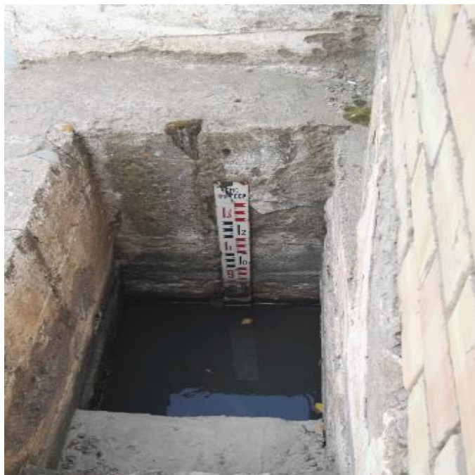
Рис. 2. Успокоительный колодец на гидропосту «Аламедин».
