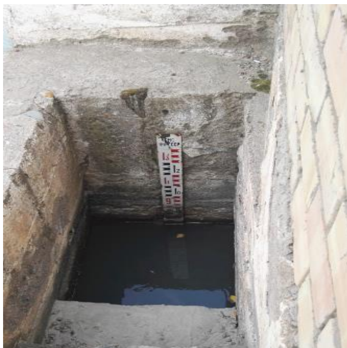
Рис. 2. Успокоительный колодец на гидропосту «Аламедин».
