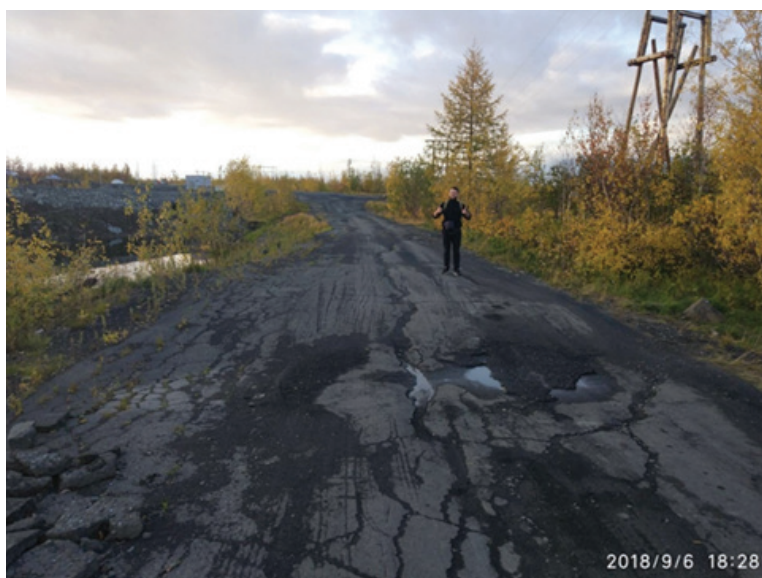
Рис. 3. Деформация дорожного покрытия в результате развития термокарста и вытаивания полигонально-жилиных льдов под насыпью дороги (фотография Толманова В.А., сентябрь 2018 г.).
