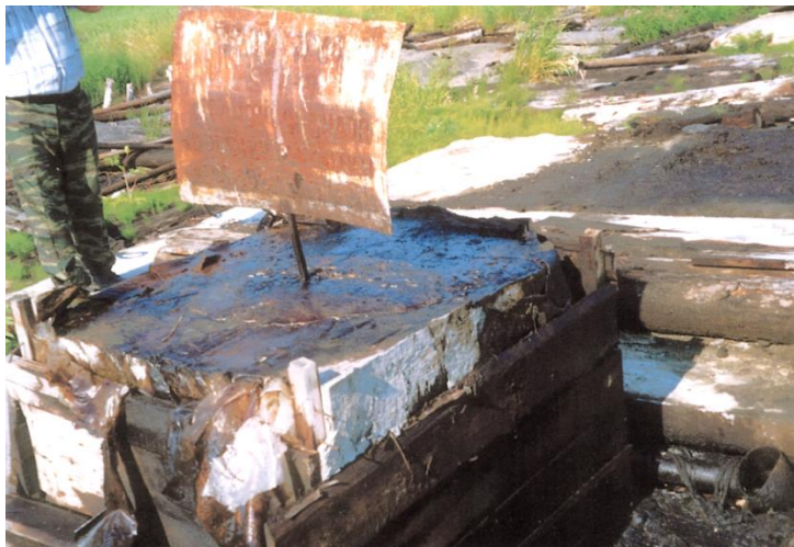
Рис. 3. Фотография ликвидированной скважины, находящейся под давлением (нефть проявляется на устье)
