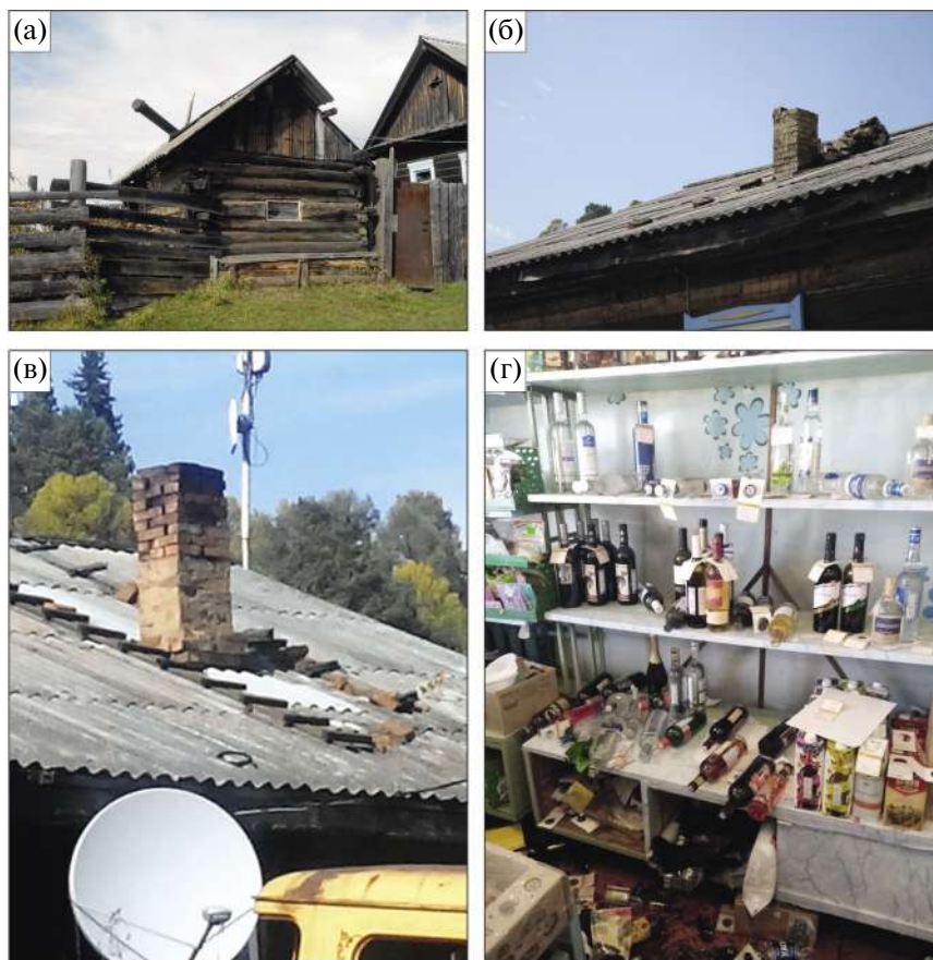
Рис. 4. Повреждения дымовых труб (а)–(в) и падение товаров с полок в одном из магазинов (г) в селе Тибельти. Фотография (г) любезно предоставлена администрацией магазина.
