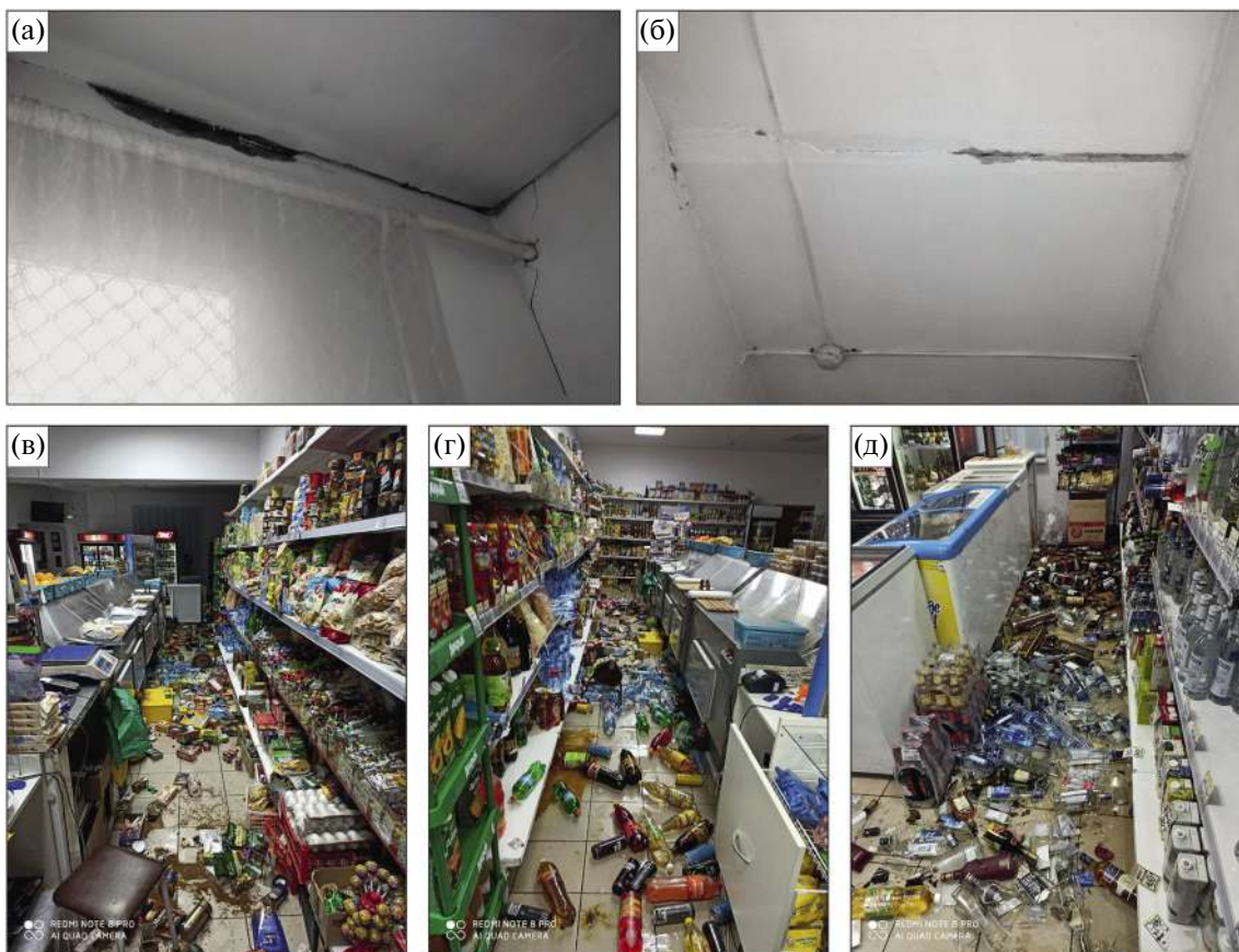
Рис. 5. Примеры повреждения штукатурки (а), (б) и падение товаров с полок в магазине (в)–(д) в поселке Култук. Фотографии (в)–(д) любезно предоставлены администрацией магазина.
