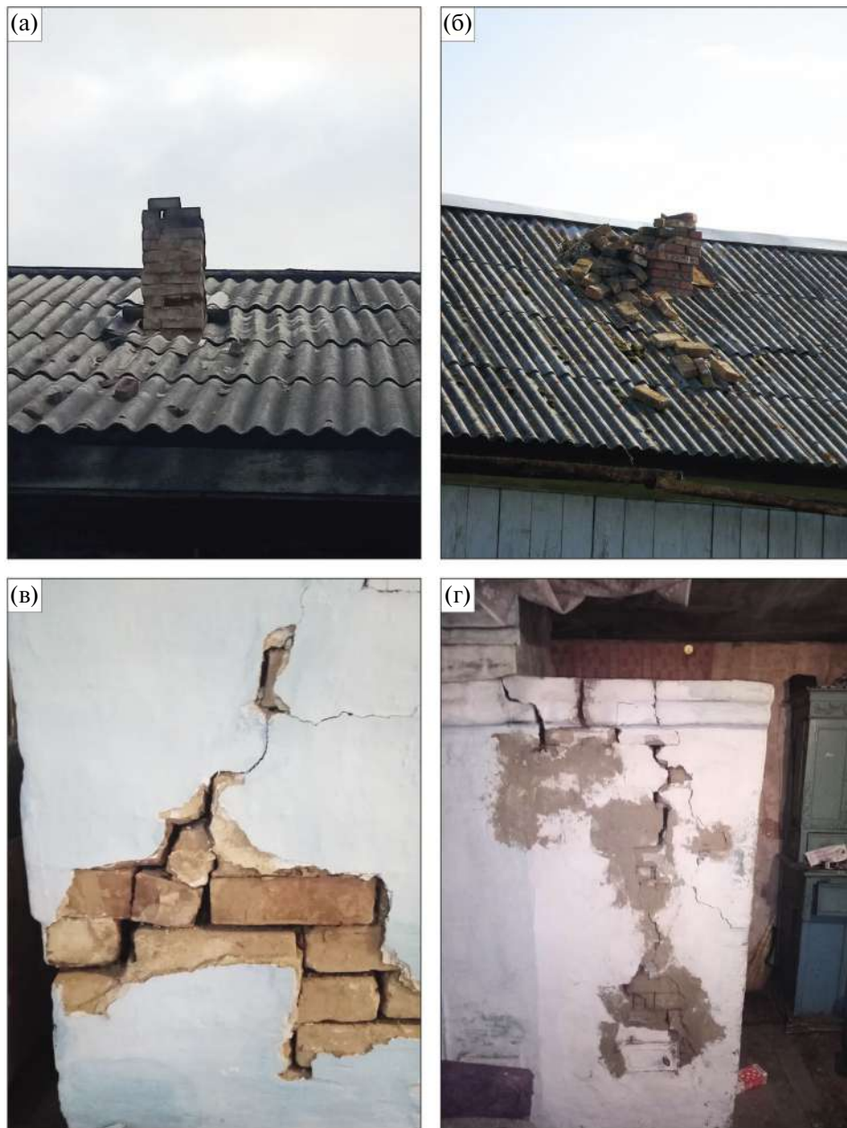
Рис. 3. Повреждения дымовых труб (а), (б) и печей (в), (г) в д. Быстрая.
